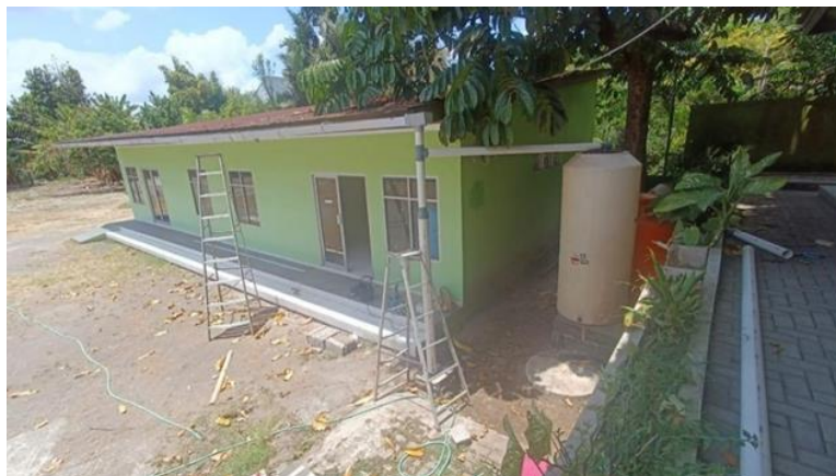
Gambar 2 Instalasi Pemanen Air Hujan
